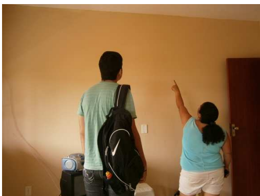
Figura 3 | A moradora Aparecida, durante o levantamento feito em sua casa, mostrando uma rachadura na parede com a qual está preocupada.
