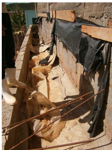
Figura 2 | Exemplo de situação encontrada em casas do Bairro Nova Viçosa. O muro do cliente foi executado de acordo com o projeto, mas o do vizinho interferiu e provocou rachaduras.
